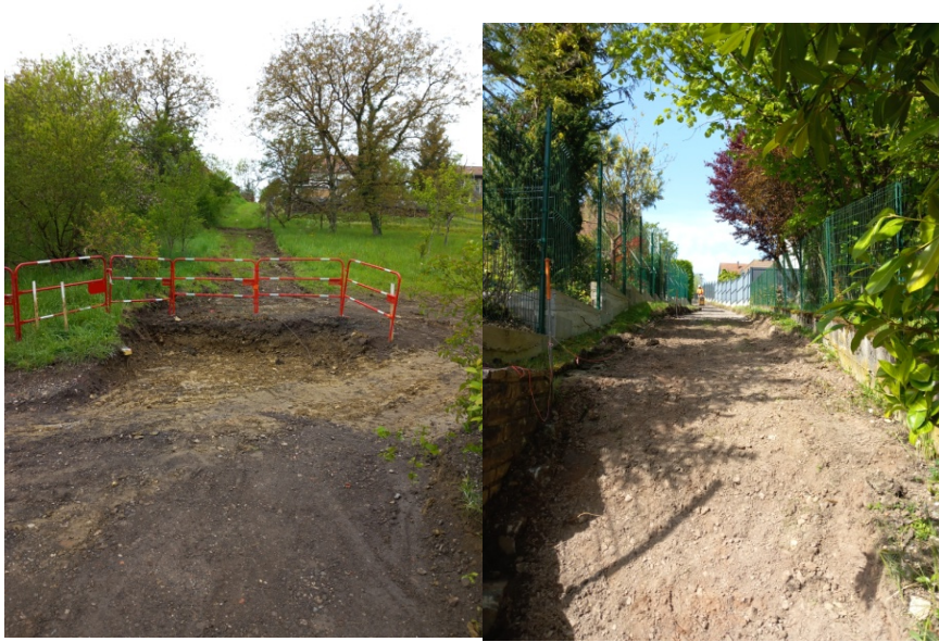
Fig : 14. Printemps 2024 début des travaux sur le tracer qui relie le bas du village au lotissement du Hobberg.
