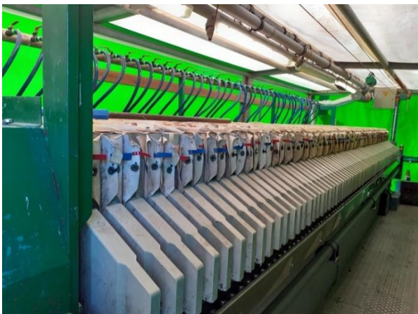
Vue sur l'intérieur de la presse à boue.
